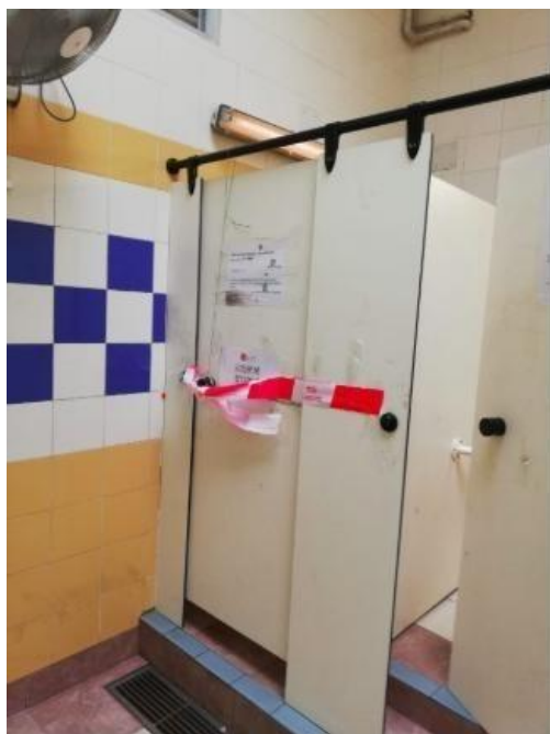
安德道遊樂場公廁廁格待修未處理（香港廁所協會提供）
