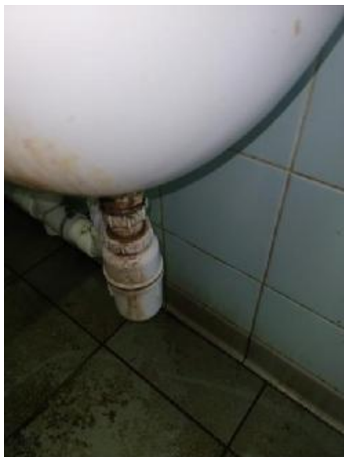
大元邨公廁有渠底生鏽未處理（香港廁所協會提供）
