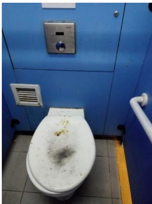
北河街公廁廁蓋有污漬（香港廁所協會提供）
